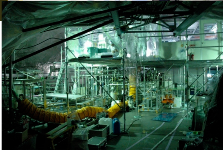
ドーム内クリーンルーム
