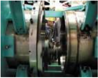
原子炉容器バルブ補修溶接装置
